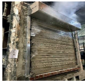
PROTECCIÓN CONTRA INCENDIOS
